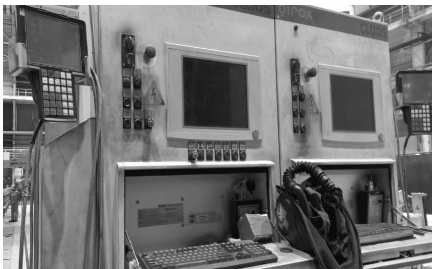
Рисунок 2 – Шкафы управления слева №1, справа №2
